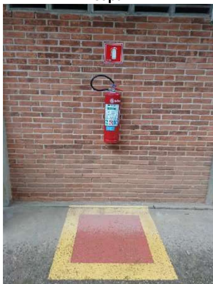
Figura 126: Extintor de incêndio - lateral a copa
