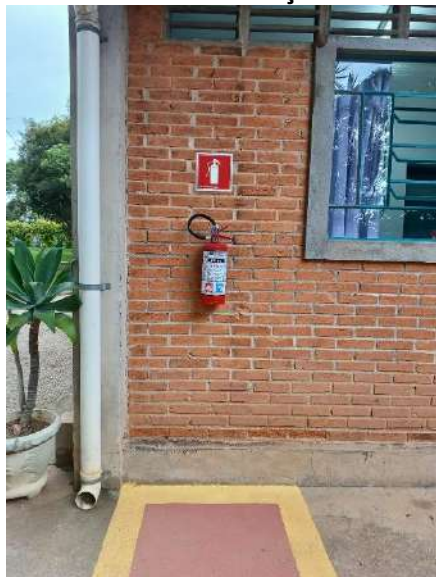
Figura 124: Extintor de incêndio - em frente a administração
