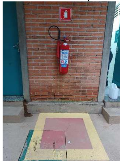
Figura 125: Extintor de incêndio - em frente aos banheiros públicos
