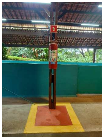
Figura 127: Extintor de incêndio - lateral a bocha
